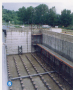
5 I lavori d'impermeabilizzazione sono ormai ultimati entro un paio di settimane a totale stagionalità dei materiali le vasche verranno gradualmente riempite e l'impianto entrerà in funzione.
